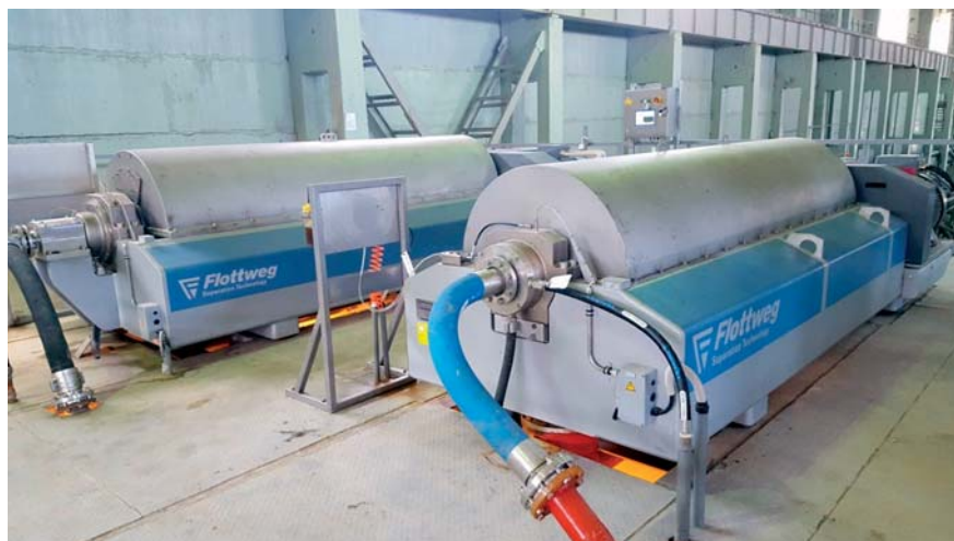
Комплекс по обезвоживанию осадка шахтных вод Учалинского ГОКа
